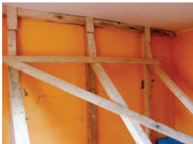
Poruchy zdiva v bytě ve 4. NP sousedního objektu, 16. září 2013
