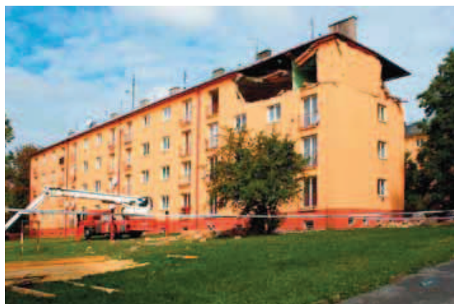
Poškozený vchod, 15. září 2013
